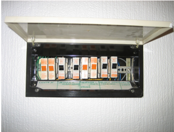
Figuur 14: Zekeringkast in het toilet
